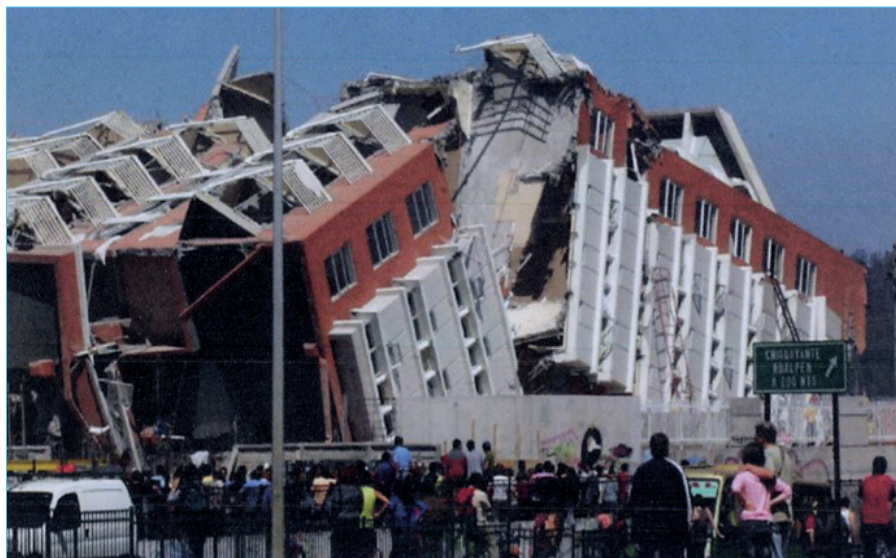
Wie Kartenhäuser fielen die Gebäude beim Erdbeben zusammen
